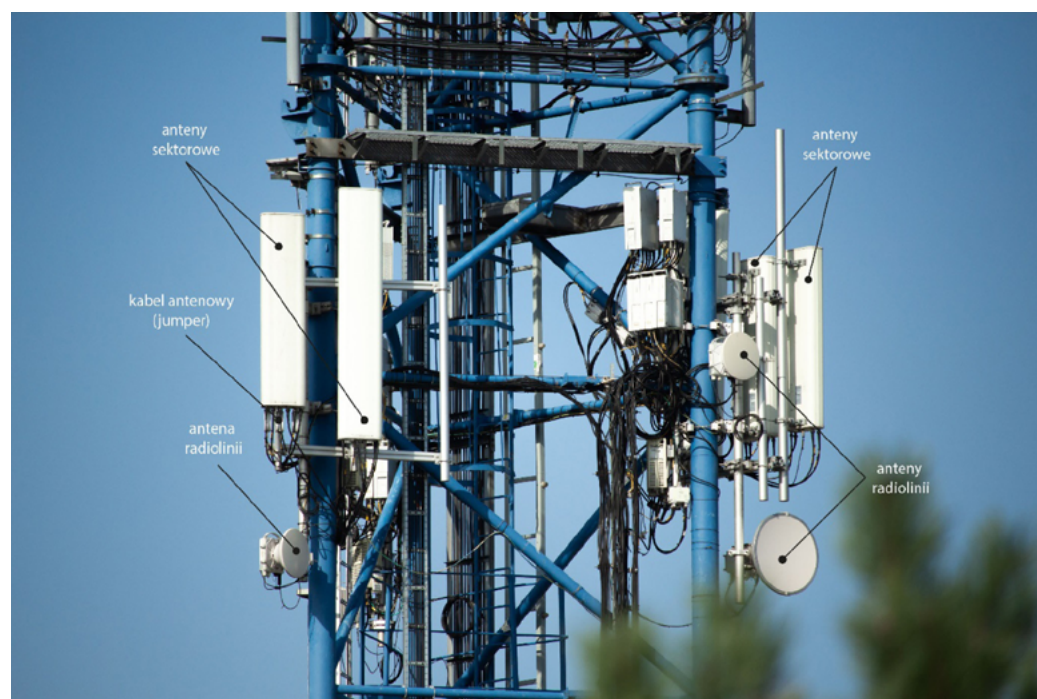
Rys. 6 Anteny stacji bazowej telefonii komórkowej
